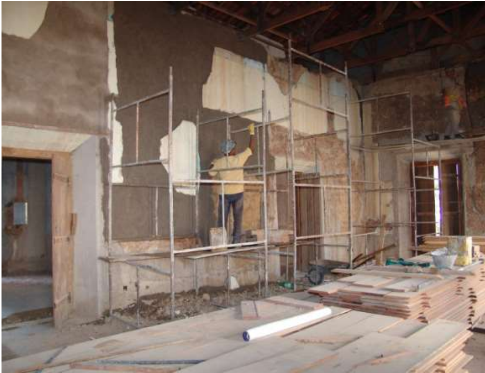
Restauro da parte interna do salão do solar de Melgaço. Acervo IHGMT
